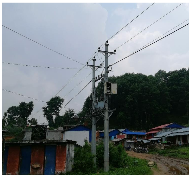
फोटो १७ वडा नं ५ को कटुन्जे बजारमा रहेको ट्रान्सफर्मर
